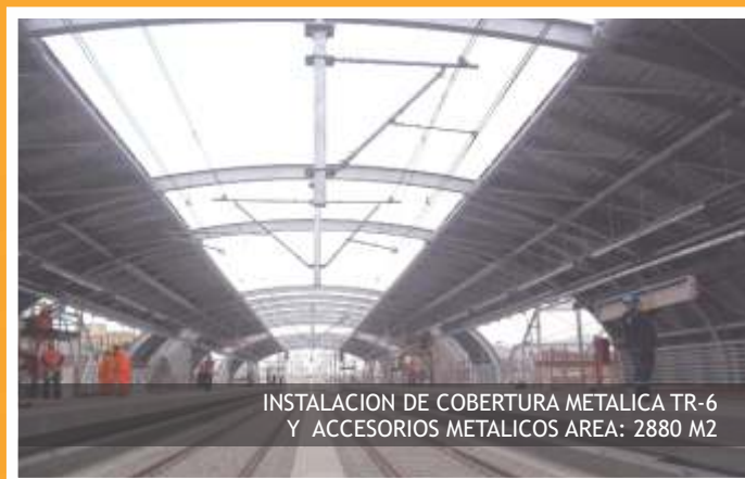
CONSORCIO TREN ELECTRICO
